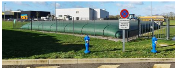
CITERNE RÉSERVE INCENDIE
